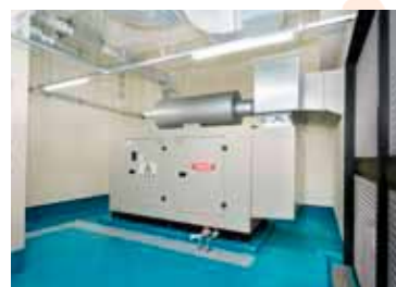
非常用発電機
